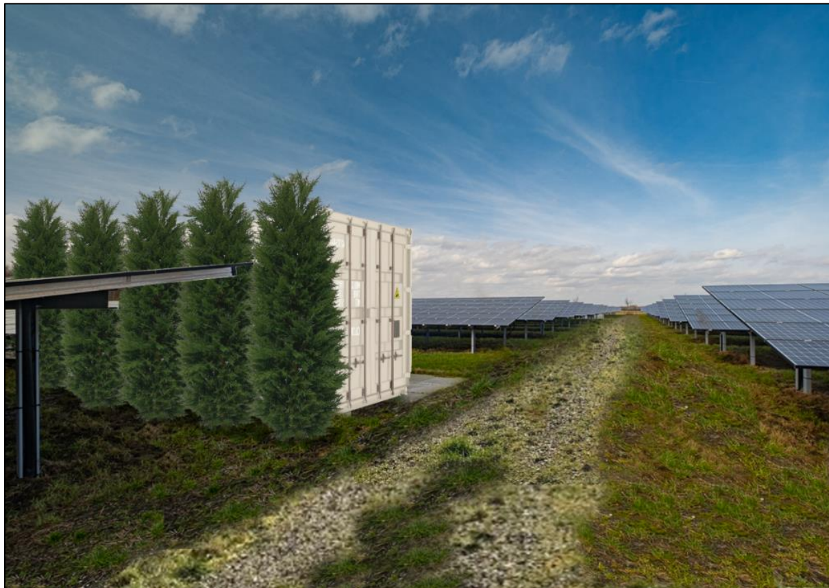
Figuur 11 Transformatorstation in lichte kleur, achter een groene haag
